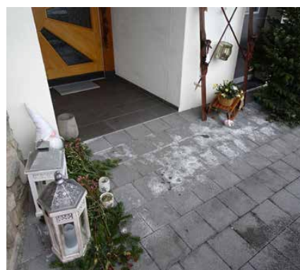
Efflorescenze calcaree su nuove pavimentazioni in calcestruzzo nella zona di ingresso
