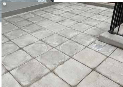
Efflorescenza calcarea sotto forma di croste bianche
