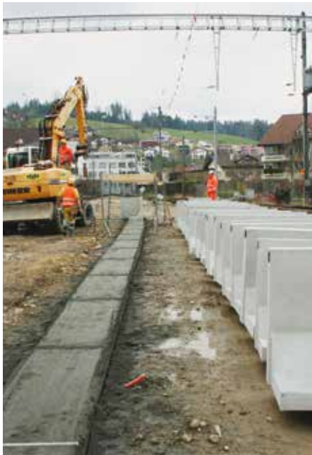
Ein exakt erstelltes Fundament ist Bedingung für das rationelle Versetzen der Perronwinkel.
